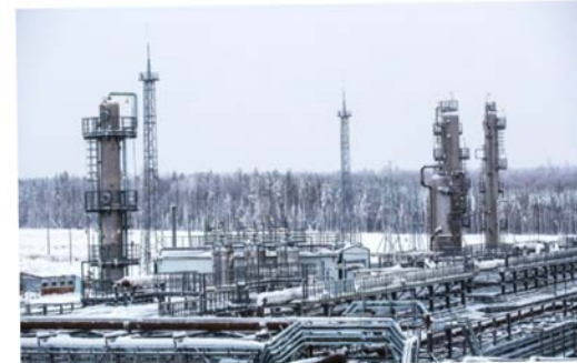
Установка подготовки нефти Ичединского нефтяного месторождения АО «ИНК-Запад». Финансово-технический аудит
